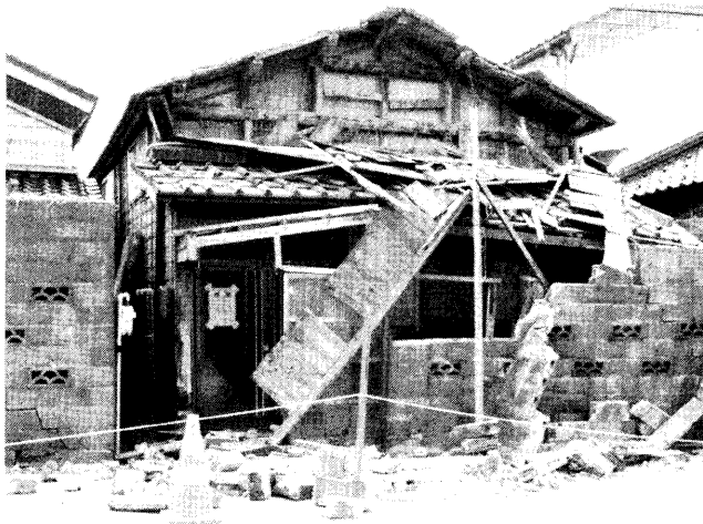
道路にブロック塀や瓦の破片が散乱
